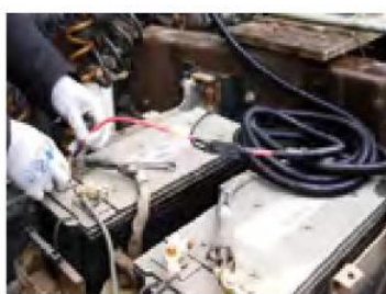
5. Подключить провода электропитания к АКБ
